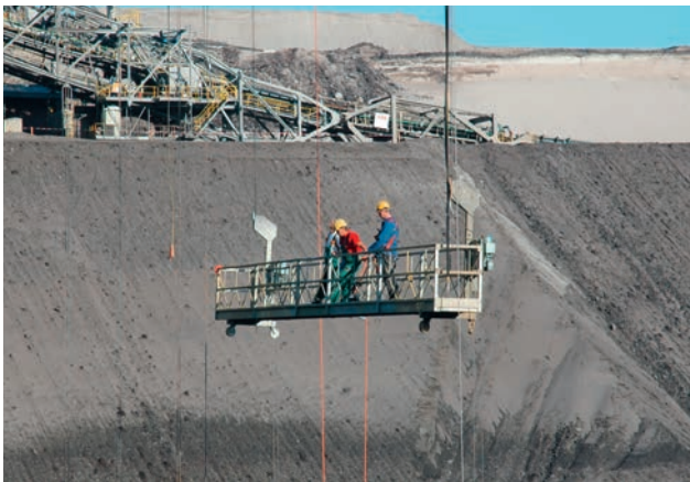
Befahranlage Tagebau Nochten
