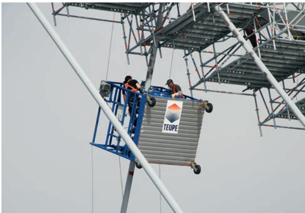
Schrägkabel Befahranlage Lanxess Arena Köln
