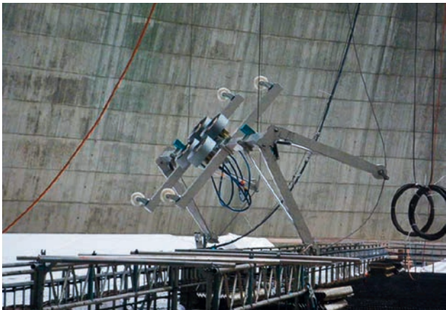
Wasserstrahlanlage Naturzugkühlturm, KW Großkrotzenburg
