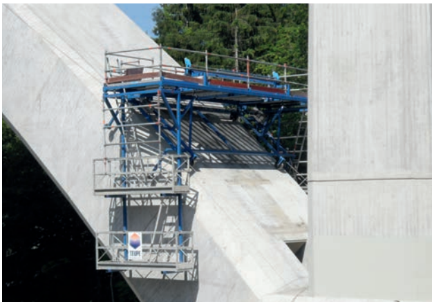
Bogenbefahranlage Bogenbrücke Truckenthal
