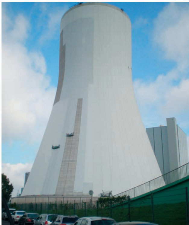
Naturzugkühlturm 180m, Duisburg Walsum
