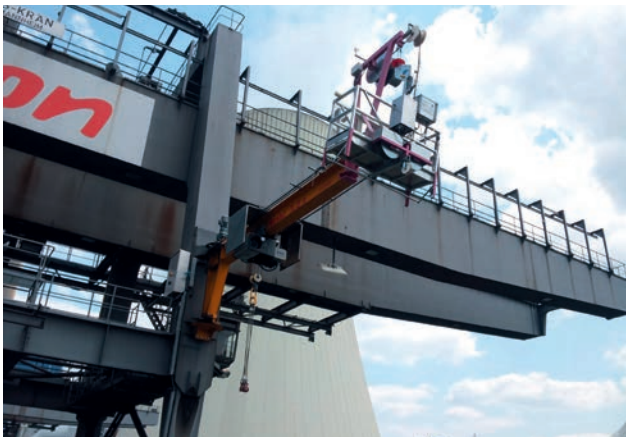
Befahranlage für Großkran Kraftwerk Staudinger
